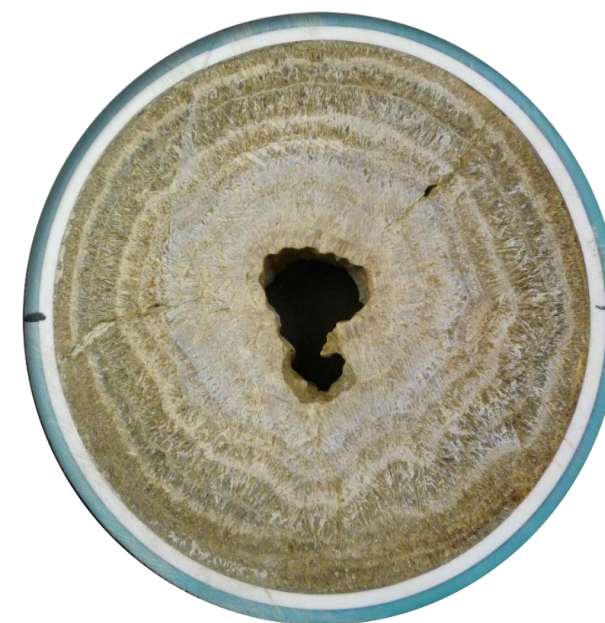
EDAR con problemas en operación por formación de estruvita
