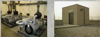
ESTACIÓN - BOMBAS DE VACÍO
