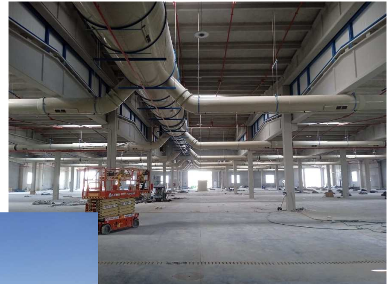
Conductos aspiración Zona Maduración
