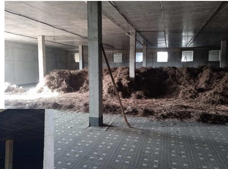
Biofiltros. Carga Biomedio.
