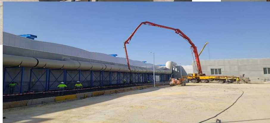
Conductos aspiración Zona Fermentación
