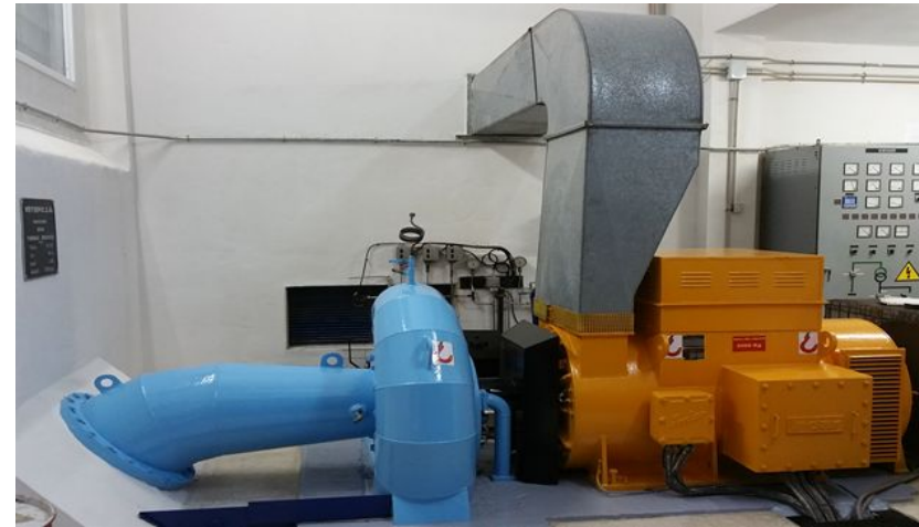
Central Hidroeléctrica en ETAP Lancha del Genil
