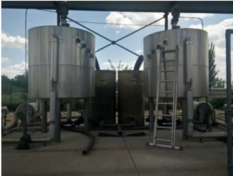
Figura 1: Plantas piloto de digestión anaerobia de fangos líquidos
