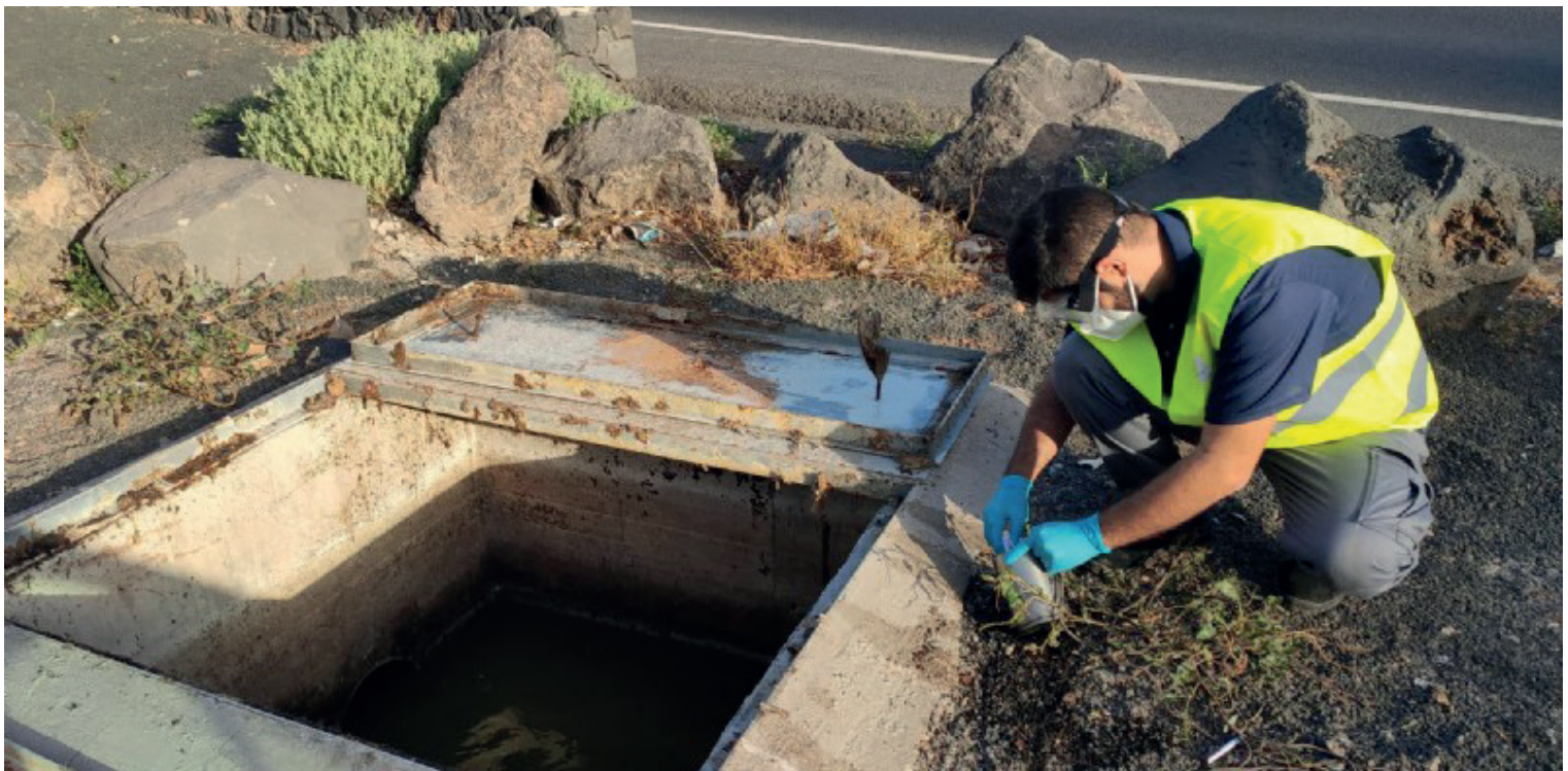
Un empleado revisa una arqueta antes de realizar la toma de muestras en Lanzarote. Foto: Cabildo Insular de Lanzarote
